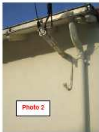
Câble de branchement, vu de près
