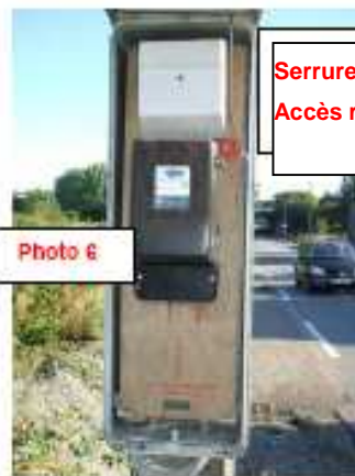
Coffret sur poteau, ouvert
